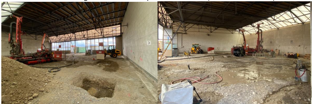
Bild 15: Grundwassereingriffe in der Bodenplatte der Halle 4 (Foto Cla Semadeni)
